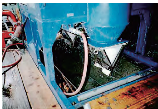
写真-5 連続排土タンク
