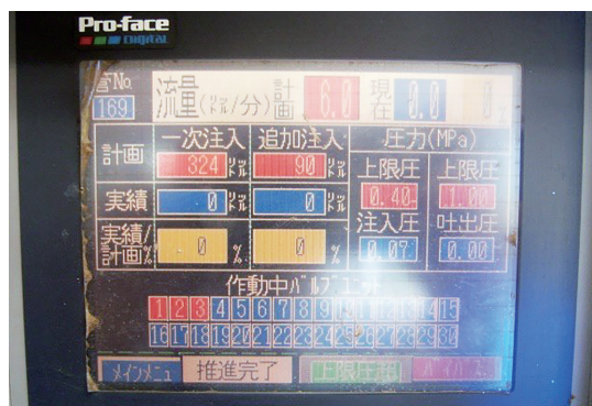
写真-2 中央集中制御盤モニタ
