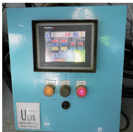
写真-1 中央集中制御盤
