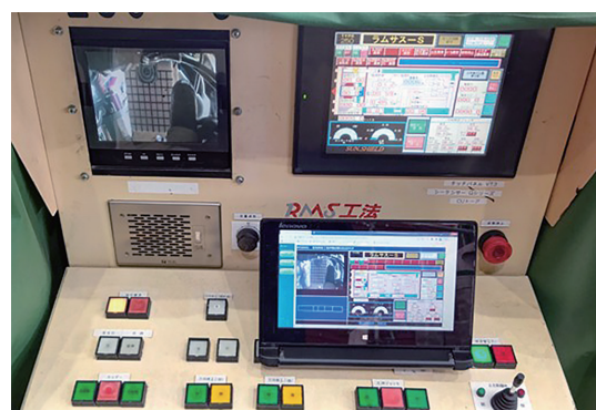
写真－3 リモートモニタリングシステム
