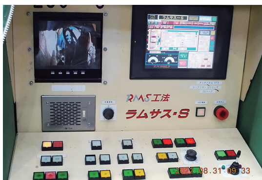
写真－1 試験対象とした操作盤
