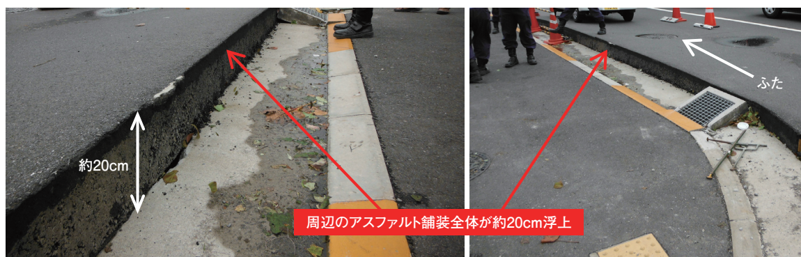
写真-2 内圧によるマンホール周辺舗装の浮上例
