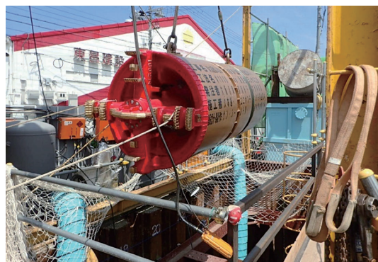
写真-1 現場で使用された呼び径1000掘進機の吊り下ろし状況
