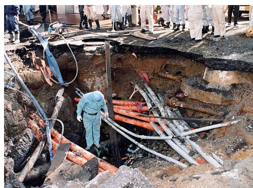
写真-2 横浜市西区鶴屋町2丁目交差点口径22インチ管破裂状況（横浜市水道局ホームページより）
