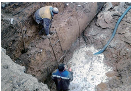
写真-2 下水道管きよ被害（ハルキウ市）
