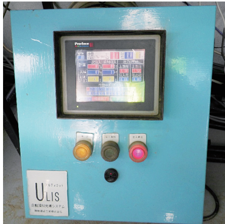
写真-1 中央集中制御盤
