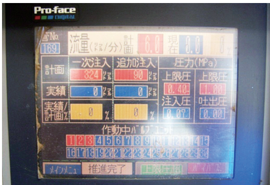
写真-2 中央集中制御盤モニタ
