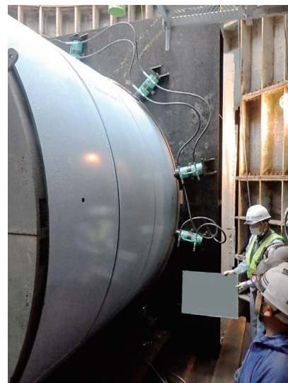
写真-2 バッキング防止設備
