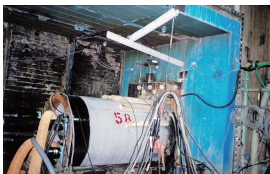
写真-2 ステーション内部
