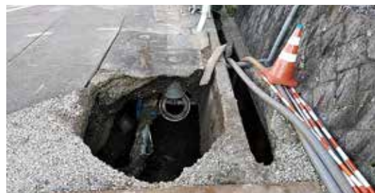
写真-3 発進鏡切時の出水(上)・陥没(下)例
