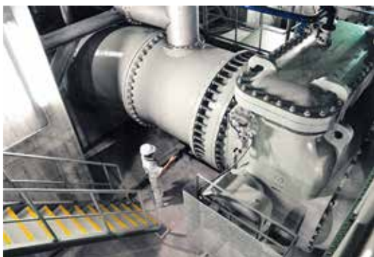
写真-2 新千田ポンプ場（雨水ポンプ場）
