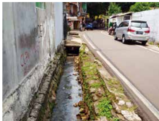
写真-1 バラック街から流れ出る生活廃水（ジャカルタ中央区裏小路）
