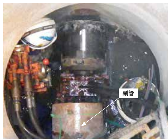
写真-1 既設マンホール内からの発進（上部に副管がせり出している）
