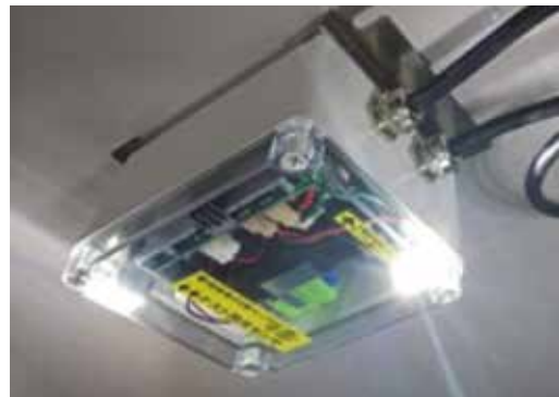
写真-2 Wi-Fi機能付きLED照明非常用バッテリー
