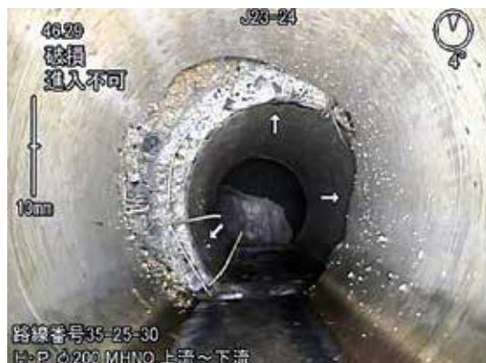
写真-1 コンクリート管の破損状況
